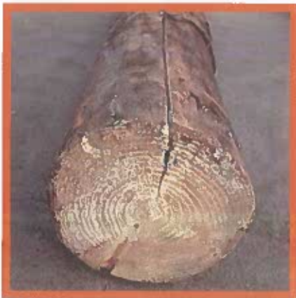
Crăpătură pe suprafața laterală
